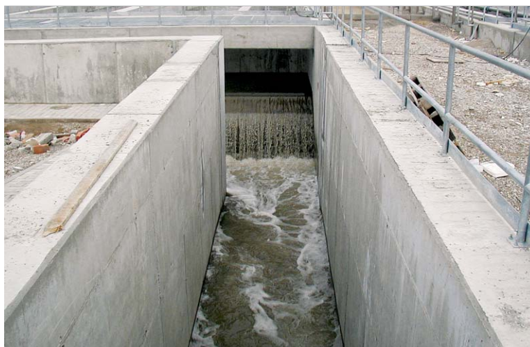
Pjeskolov pročišćivača u vrijeme probnog rada
