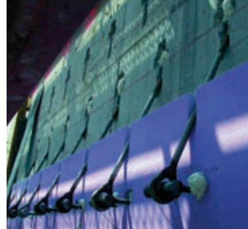
Autorska prava: Alfons Ottiger, Zug Unutarnja, nosiva betonska oplata, rupe za sidra, izolacija i široka sidra za prihvat elemenata fasade.
