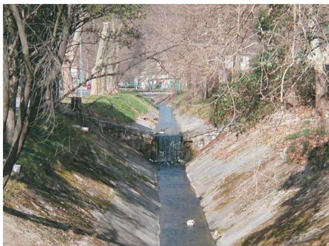
Otvoreni kanal otpadnih voda koji prolazi kroz Rašu
